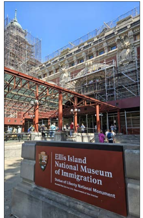
Budynek Biura w 2025 roku (w trakcie renowacji), główne wejście do Narodowego Muzeum Imigracji
