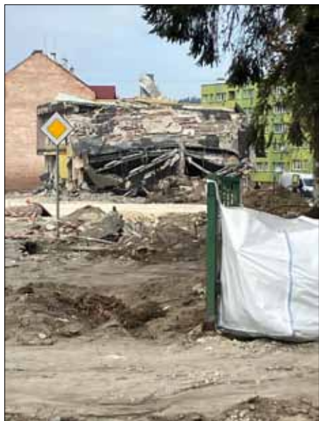
Po przejściu fali powodziowej
