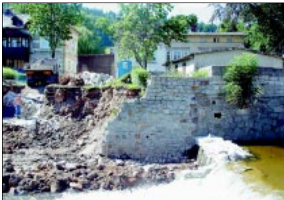
Piechowice zniszczone umocnienia koryta Kamiennej.
